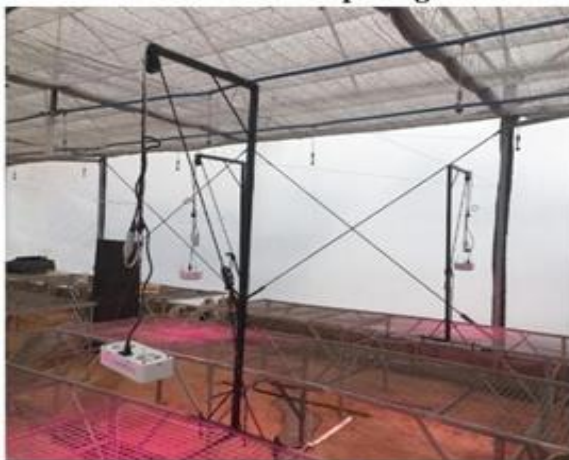
Diodos emissores de luz instalados em ambiente protegido
